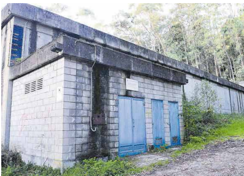
Exterior del depósito de agua de Coiro, que abastece a Cangas y a Moaña. | Gonzalo Núñez
