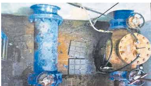
Válvulas obsoletas en el depósito de Coiro.
