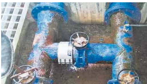
Mal estado de las tuberías del depósito.
